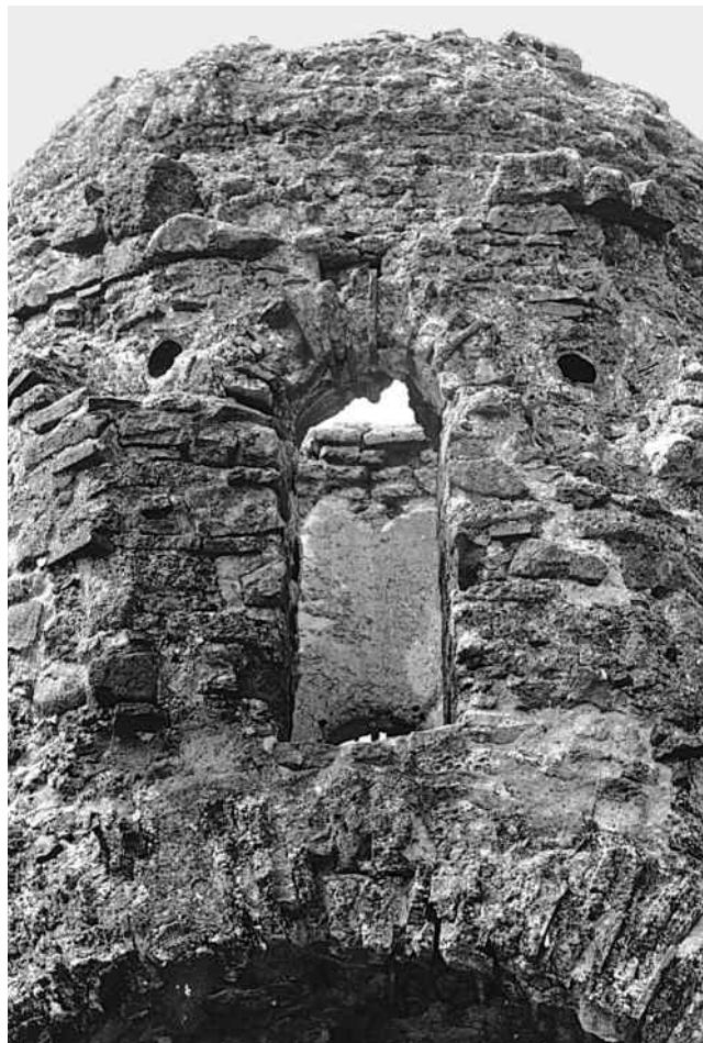
8. Остатак ојачања куполе и траг венца изнад њега 8. Remains of the dome's reinforcement and a trace of a cornice above it
