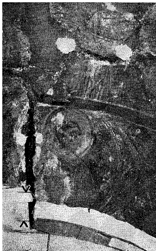
1. Манастир Благовештење, под Кабларом, пукотина у темељу источног попречног лука — стрелице показују смицање сводова по хоризонтали
