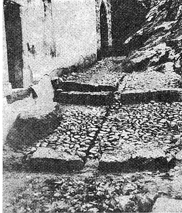
4. Borač, le drainage et le trottoir du côté nord de l'église, pendant l'exécution des travaux et après.
