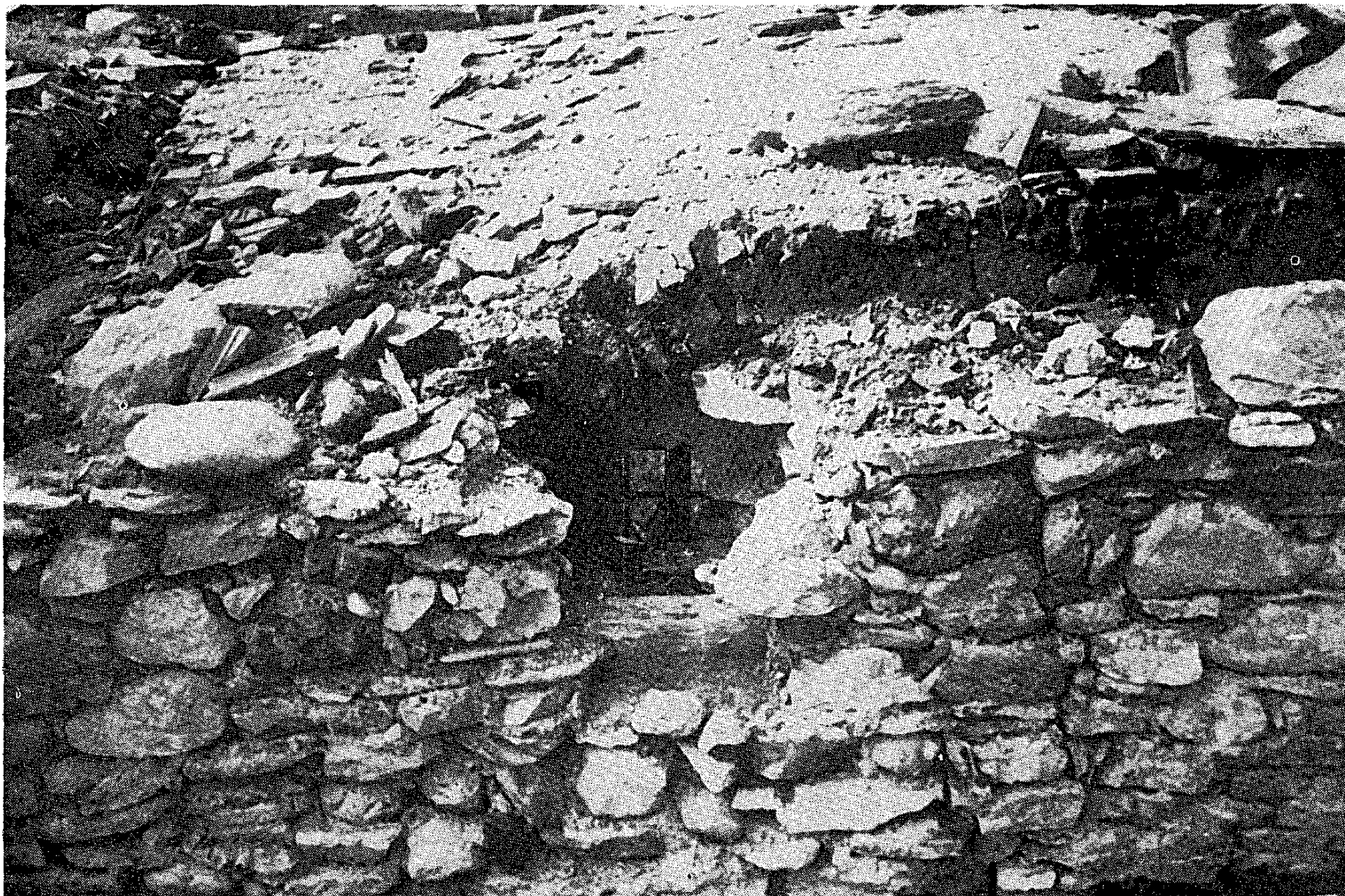
110. Милошев конак, изглед старијег каменом озиданог подужног зида и крстастог свода који су радили Милошеви мајстори. Зид је проваљен а свод испуцао, Р. Живковић.
